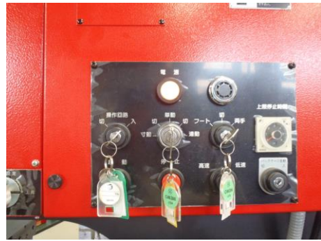
図7 プレスブレーキのカギおよび起動ボタン
