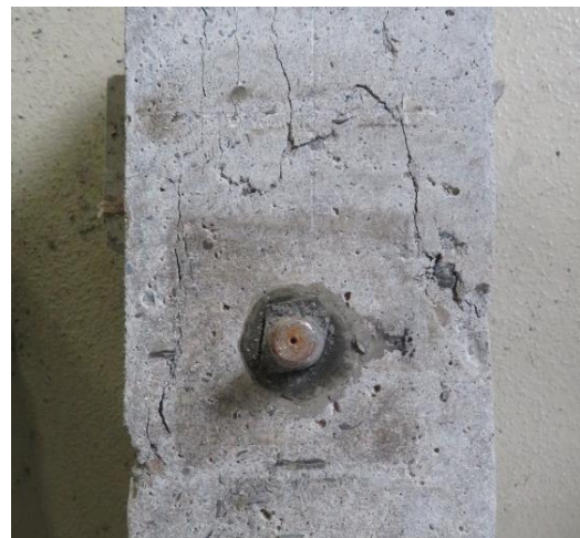
写真 5 試験体 C3 面 S1 の鋼板直下のひび割れ状況
