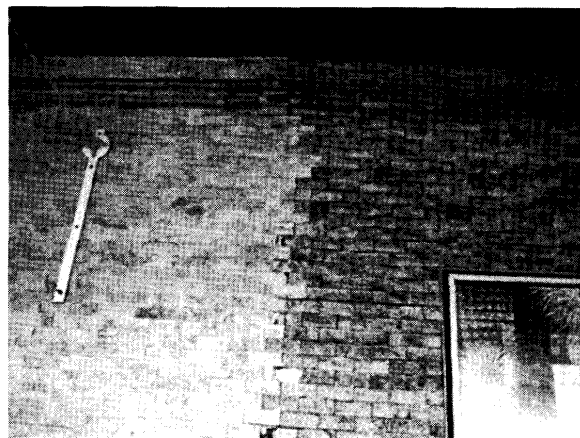
写真-1 長岡駅壁面のクラック
