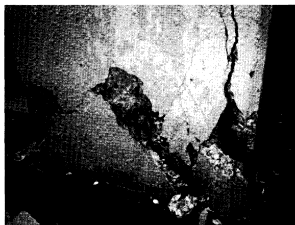
写真 - 46 プロパンガスの小屋の圧壊
