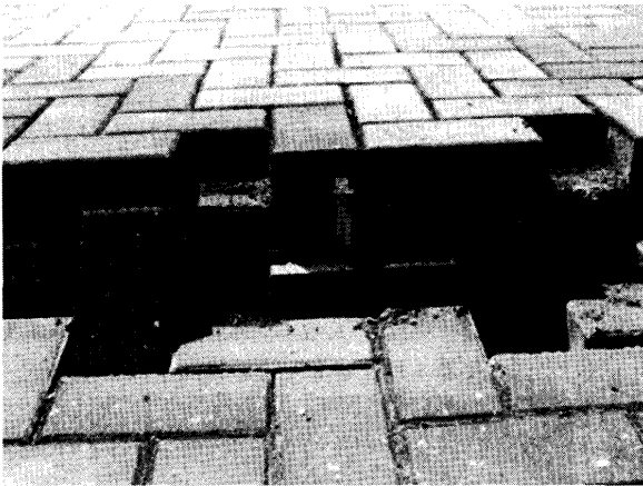
写真-8 能古島岸壁の被害状況
