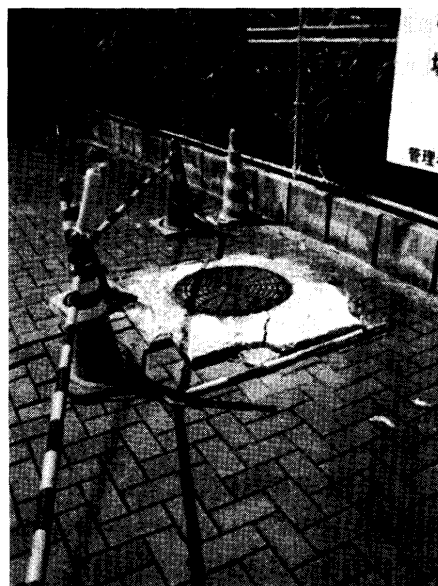
写真-3 姪浜港マンホールの浮き上がり
