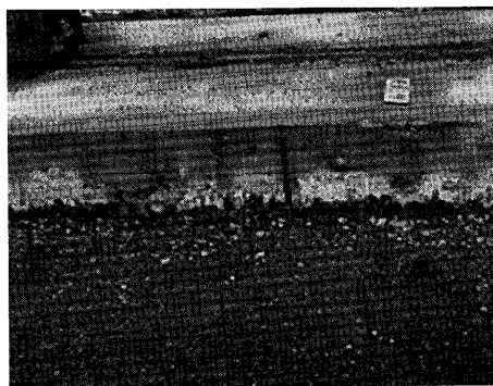
写真-1 砂田橋スケーリングと剥離
