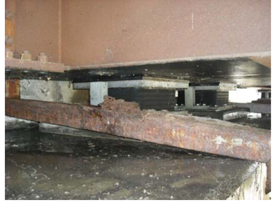
図13 平瀬橋横構の腐食
