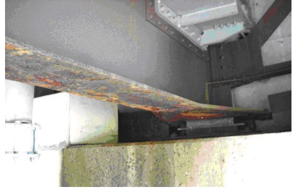
図1 耐候性鋼板損傷状況
