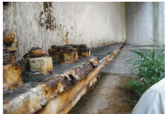
図4 ボルト接合部腐食状況
