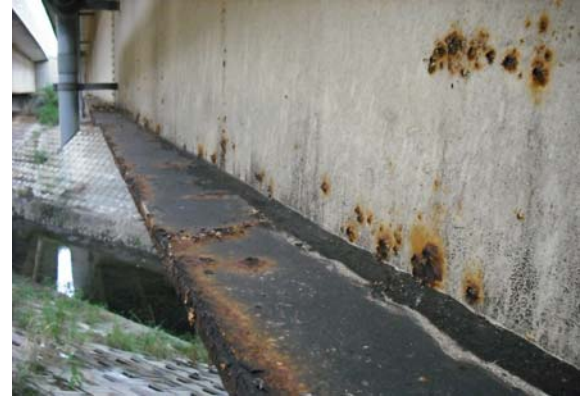
図3 下フランジ損傷状況
