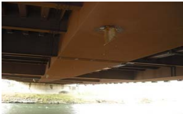
図12 排水工周りの腐食
