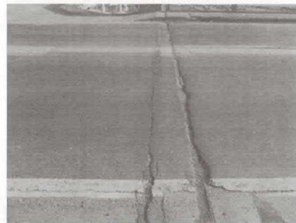
写真3 車道部ひび割れ
