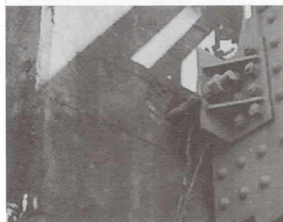
写真 24 落橋防止用ボルト損傷
