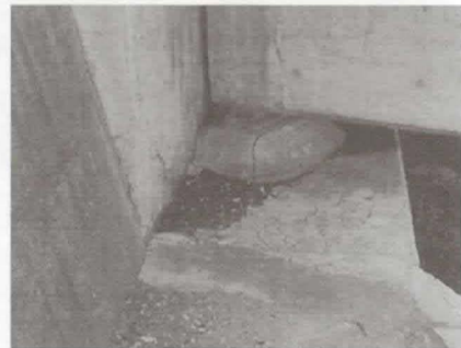
写真4 支承部支持コンクリートひび割れ
